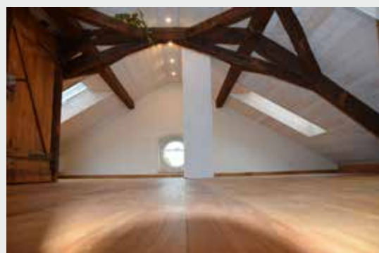
Zur Dämmung wurden auf dem Dach Holzweichfaserplatten verlegt und zwischen den Sparren Zellulose eingeblasen
